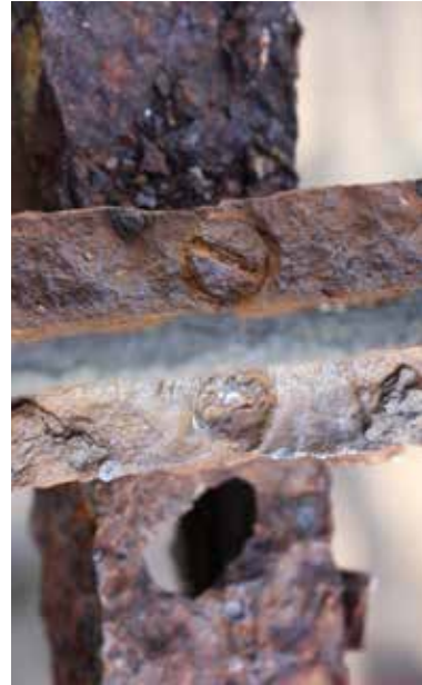
Schäden an Pfosten, Zierprofilen, Mauersockel, Untergurt und Sparrenauflage
