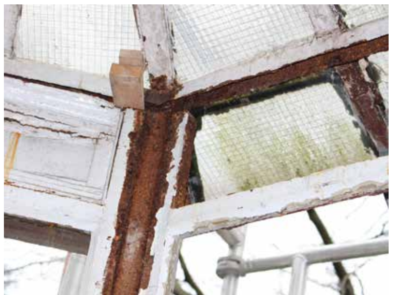
Schäden im Bereich des Dachanschlusses
